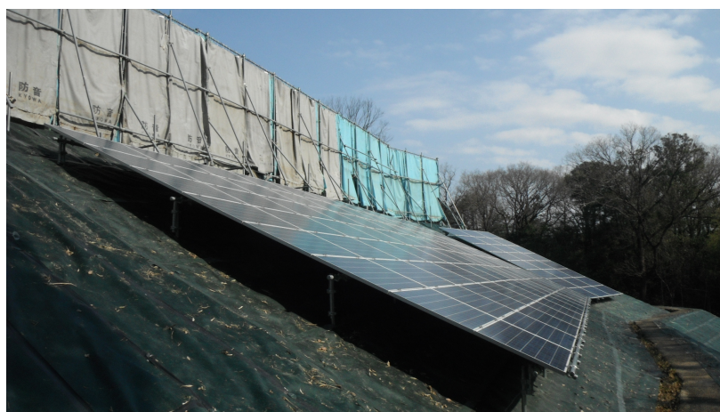
(太陽光パネル(第 2 プラント))
